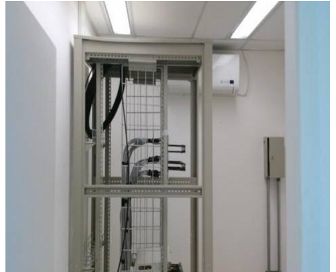
SALA DOS SERVIDORES
